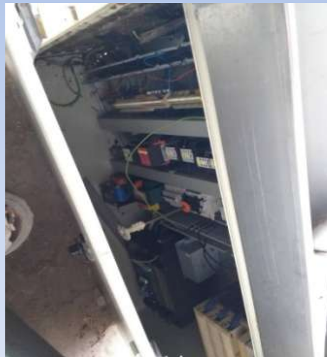
Электрощкаф в комплекте
